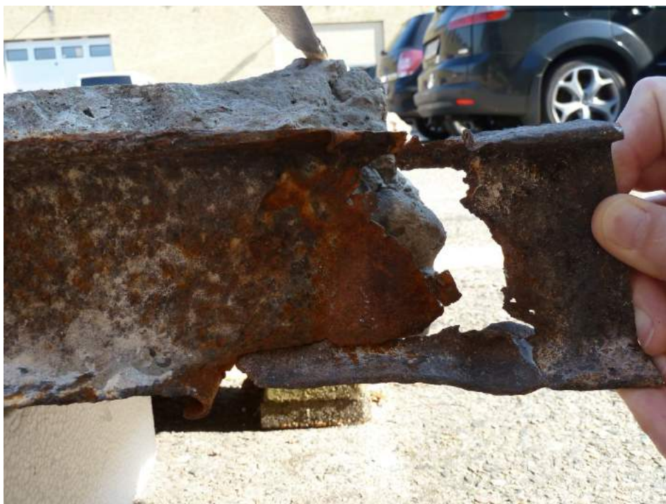
Figur 15 Korrosionszone i kollapset udliggerjern. Tommestokken angiver beliggenheden af facadeplanet. Stykket til venstre ses i sin helhed i figur 16.
