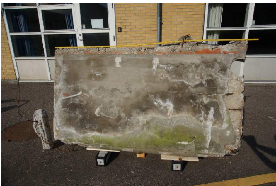
Figur 17 Underside af kollapsede altanplade (Foto: Pelcon ApS)
