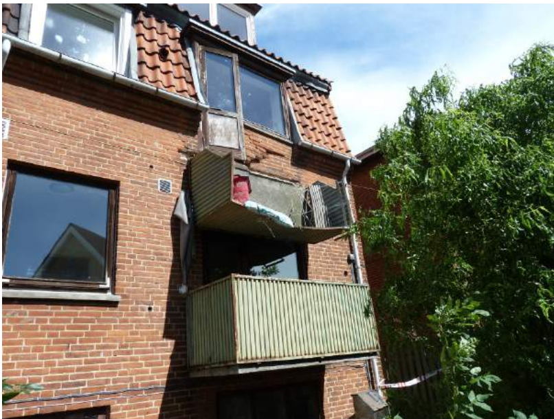
Figur 1 Intakt altan og kollapsede altan
