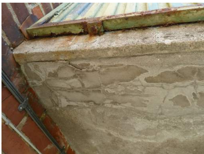
Figur 11 Delaminering af overflade
