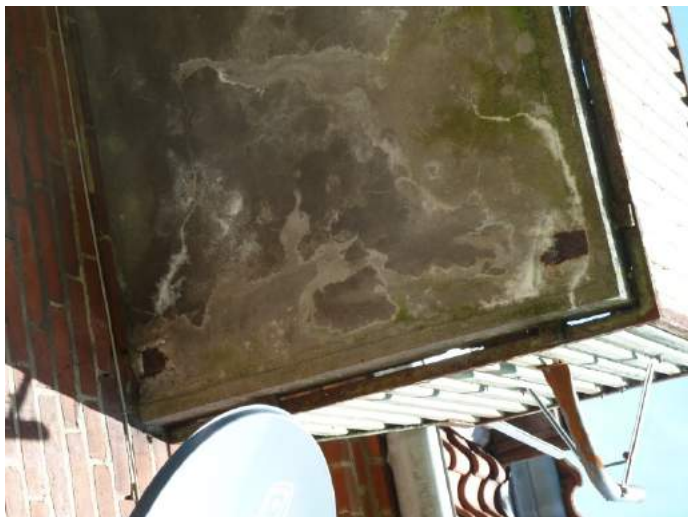
Figur 10 Underside af altan med blottagt udliggerjern
