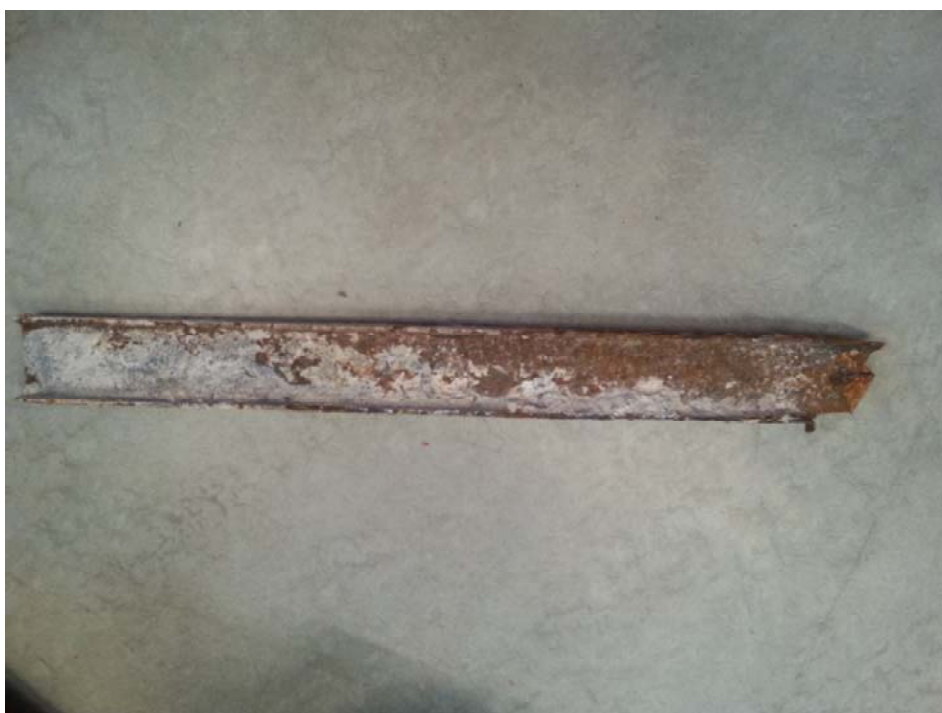
Figur 16 Udliggerjern fra kollapset plade. Den nedbrudte højre ende var placeret bag facadeplanet som vist på figur 15. (Foto: Sydsjællands og Lolland-Falsters Politi)
