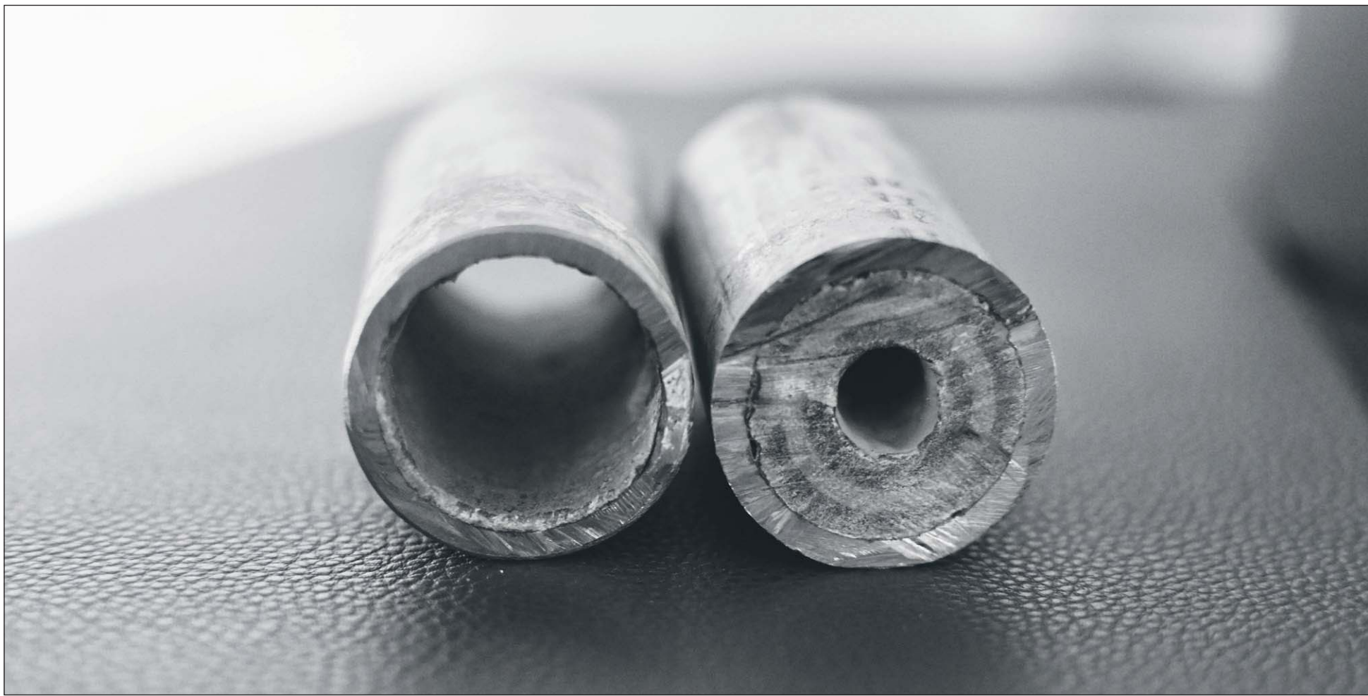
Før og efter kalkrensning. Inden en rensning gennemgår Aquatex installationen og tager stikprøver for at sikre, at rørene kan klare en rensning.
