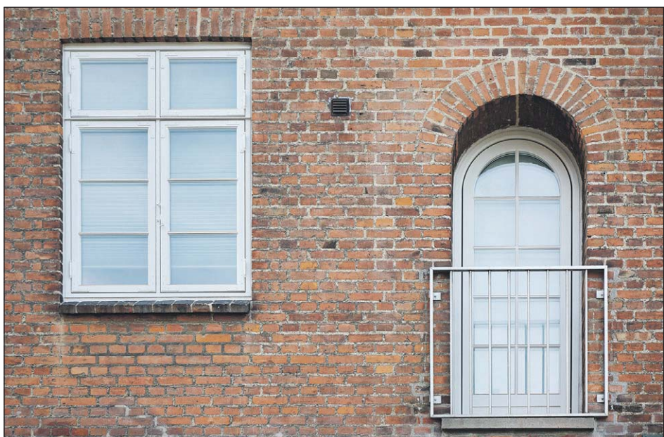
Flere af vinduerne i gadeplan er rekonstrueret, så de igen har en runding øverst.
